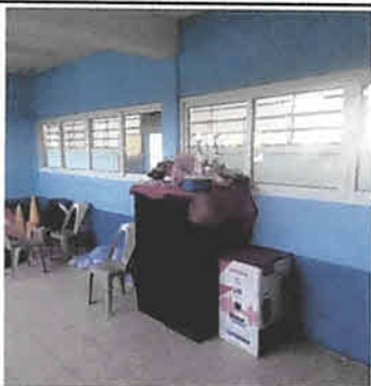
Foto1: Sellado en ventanas laterales.
