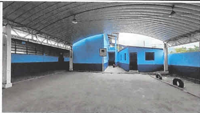
Foto1: Pintura general en muros interiores y exteriores.
